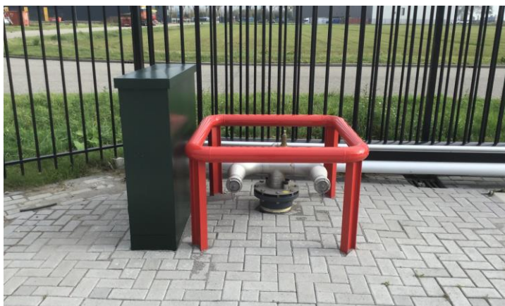
Voorbeeld geboorde put met interne bronpomp.
